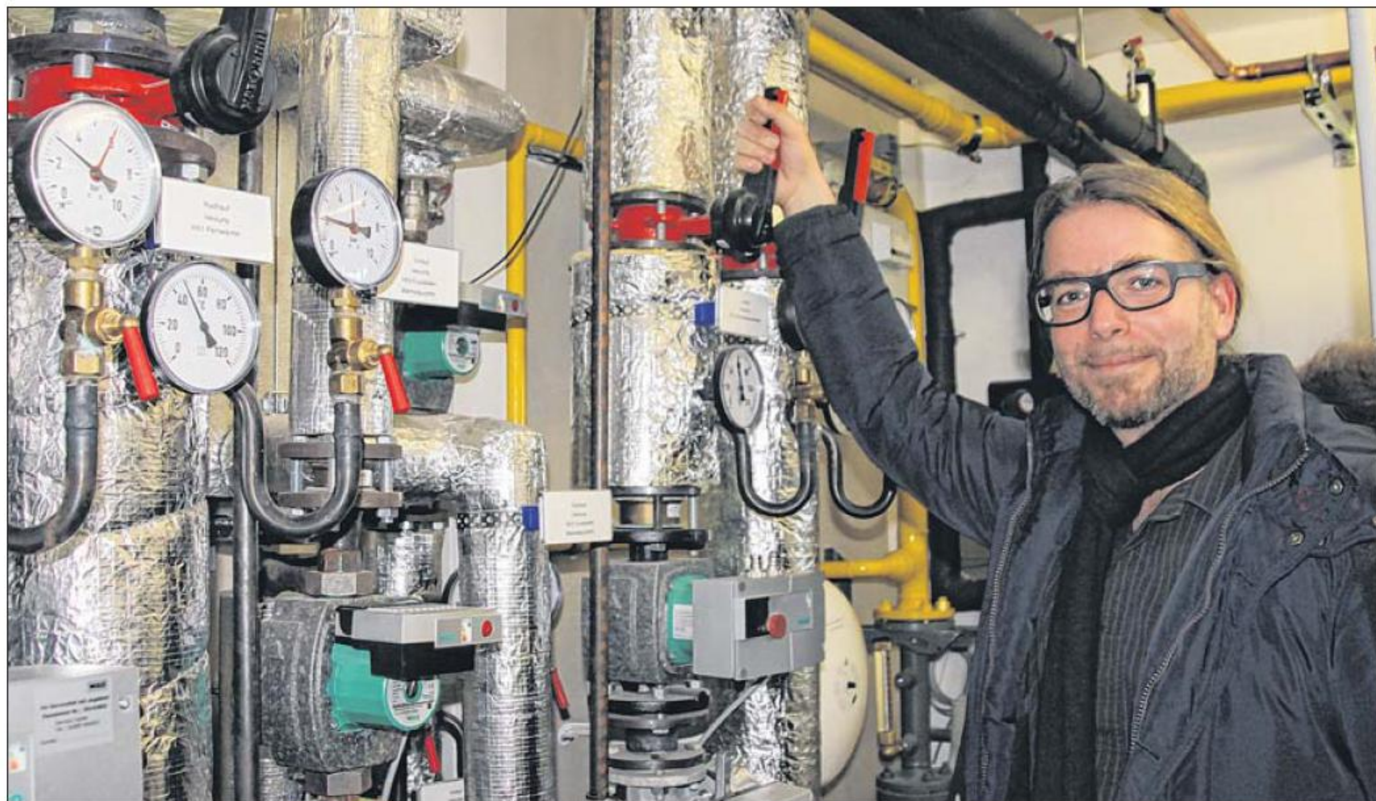
Till Jaich legte gestern symbolisch den Schalter um: Der Geschäftsführer der Wasserferienwelt in Lauterbach ging mit dem klimafreundlichen Blockheizkraftwerk ans Netz. Biomethan wird dort in Strom und Wärme umgewandelt.
