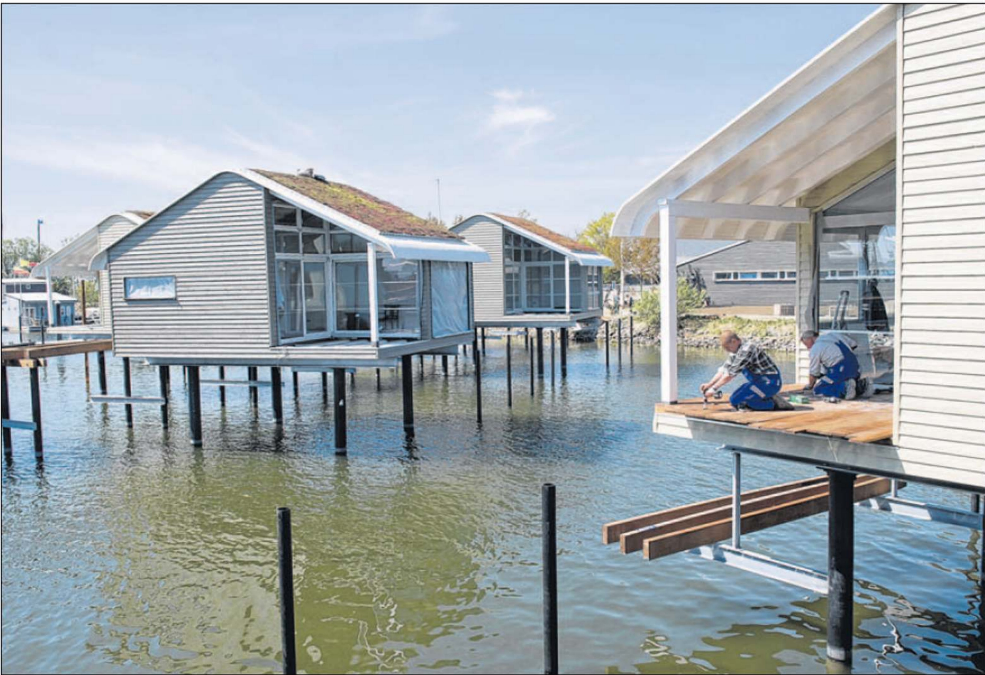
Ferienhäuser auf der Insel Rügen. Monteure bauen in der Marina „Im Jaich“ in Lauterbach an der Terrasse eines Stelzenhauses.
